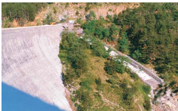
Veduta d'insieme del canale scolmatore della diga oggetto dell'intervento di ripristino ed impermeabilizzazione
