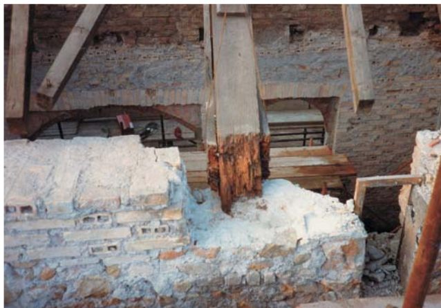
Situazione di degrado. Eliminazione dell'appoggio ligneo.
